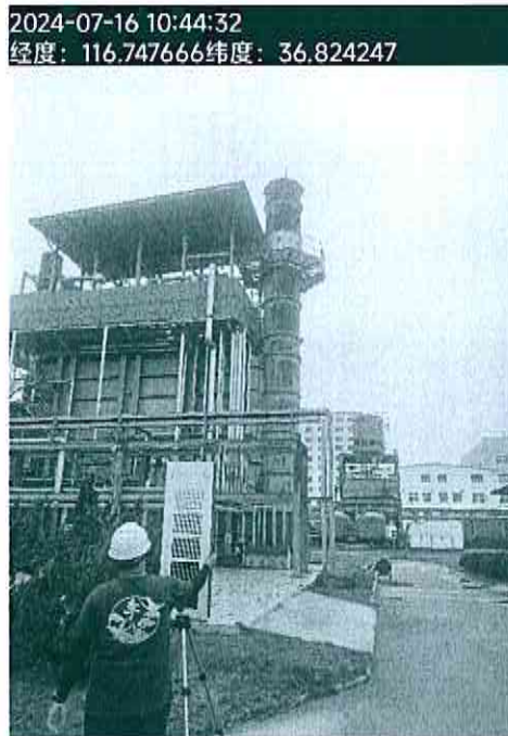
4#燃气轮机组排气筒 (DA019)
