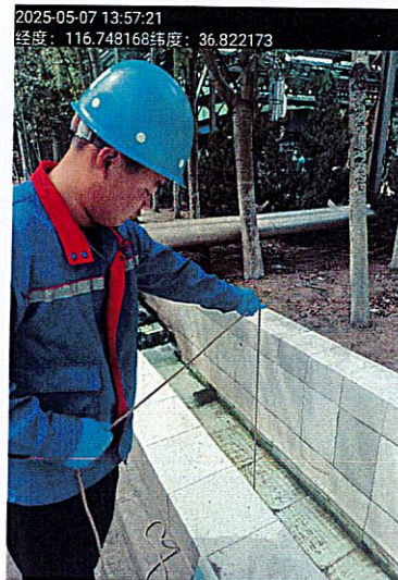
三期酚氰废水处理站清水池
