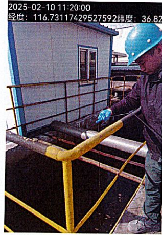
三期酚氰废水处理站清水池
