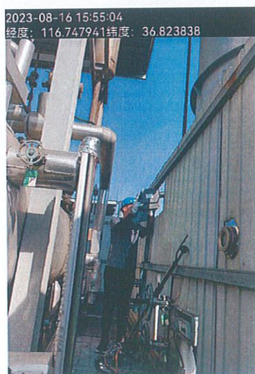
2#燃气轮机组排气筒 (DA002)
