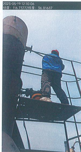
2023-05-19 12:10:06 经度: 116.73772 纬度: 36.81687 炭黑 3#收集袋滤器排气筒 (DA023)
