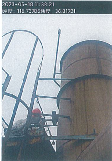
2023-05-18 11:38:21 经度: 116.73785 纬度: 36.81721 炭黑 7#8#收集袋滤器排气筒 (DA021)
