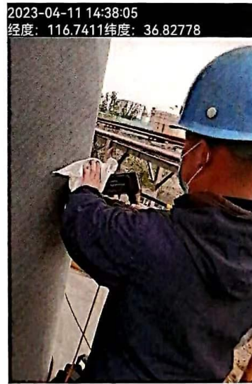
RTO 装置排气筒 (DA059)
