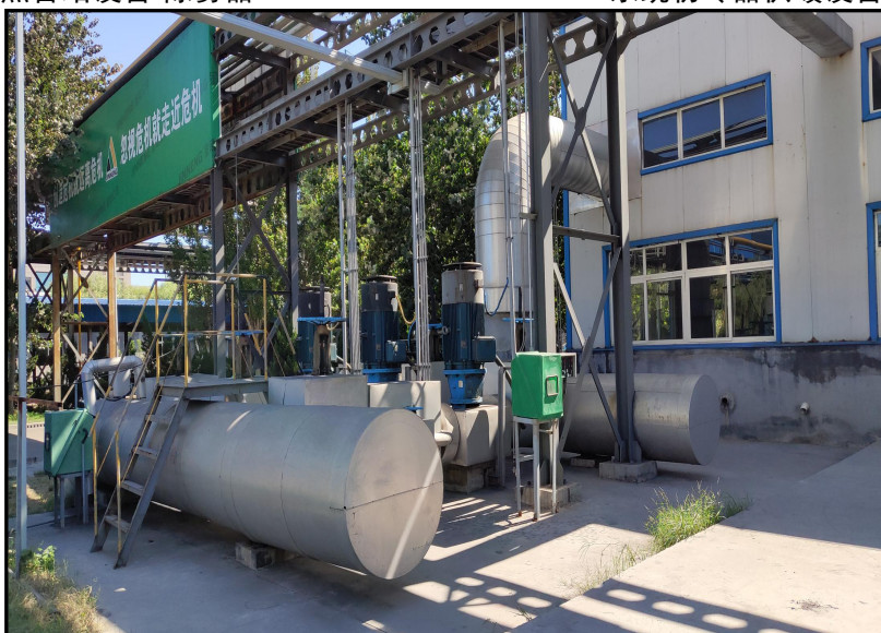
二系统初冷器供暖设备-加压站 图 3-5 该项目现状建设照片
