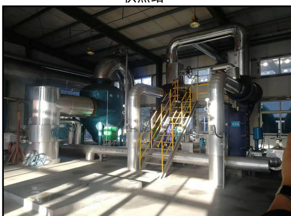
供热首站设备-除雾器
