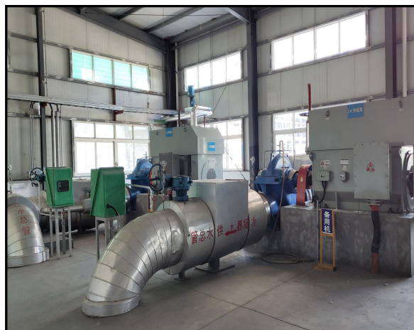
供热首站设备-主供暖泵
