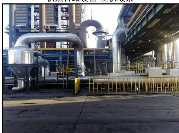
一系统初冷器供暖设备-加压站
